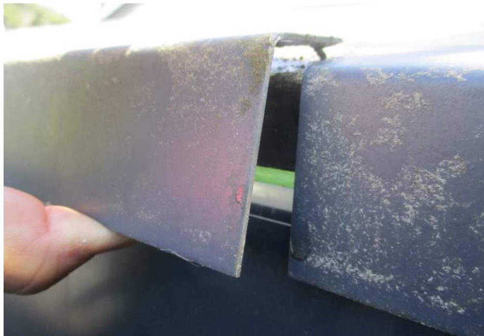
joint entre deux couvertines : bout à bout, sans étanchéité
